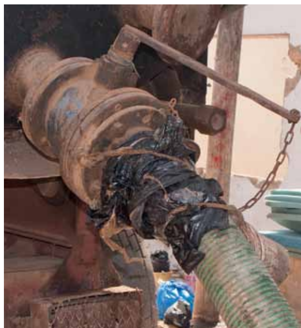
Figura 4.12 Ejemplo de una manguera mantenida indebidamente, amarrada con fundas plásticas y cuerdas (foto: David M. Robbins).
